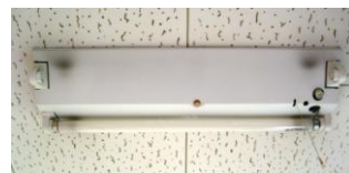
廊下の蛍光灯は 1本おきに抜いています
